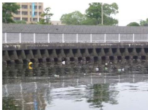
護岸沿いの海中ゴミ状況
